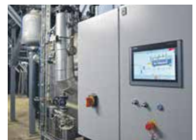
SPALOVNA má moderní technologii.
